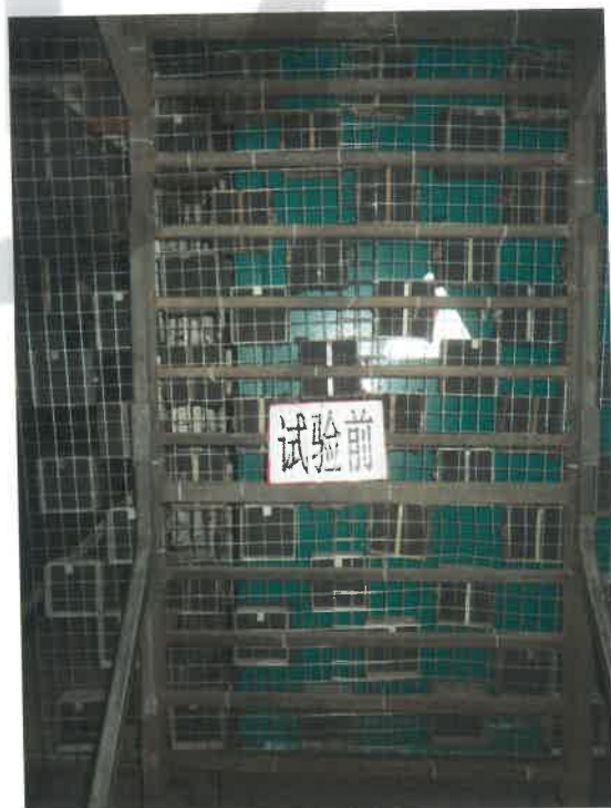
开关室试验前 侧面 2
