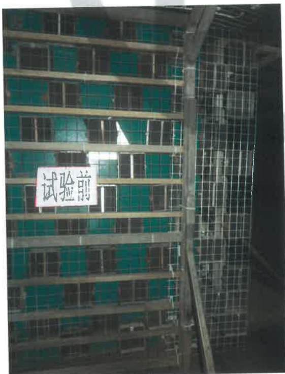
开关室试验前 侧面 1
