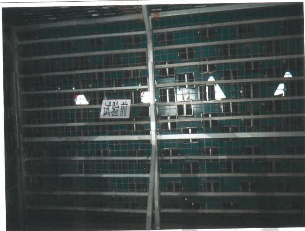
开关室试验前 正面
