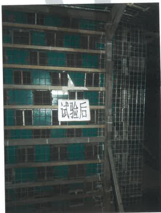
开关室试验后 侧面 1
