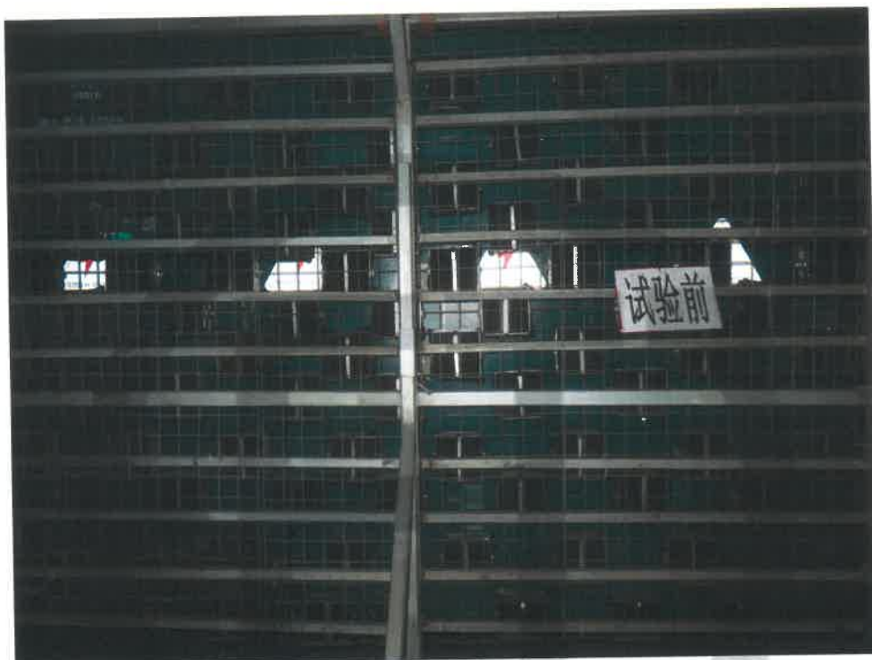
开关室试验前 后面
